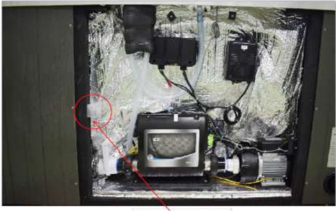
Расположение дополнительного предохранителя
